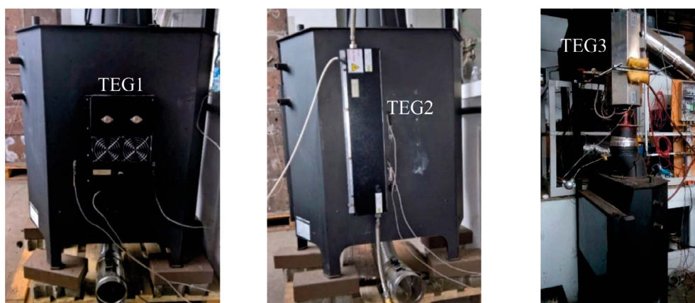
Rys. 2. Usytuowanie generatorów termoelektrycznych na powierzchni wkładu kominkowego ( TEG1 , TEG2 ) oraz na kanale spalinowym ( TEG3 )
